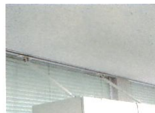
重量棚 ターンバックル固定
